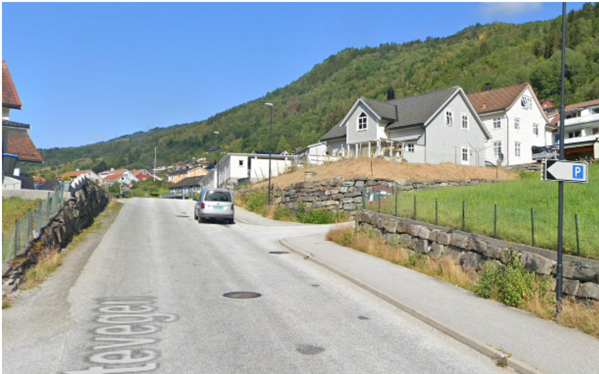
Utklipp henta frå Google Maps som viser støttemuren slik han er i dag.
